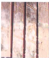
Photo 2: moisissures de surface
